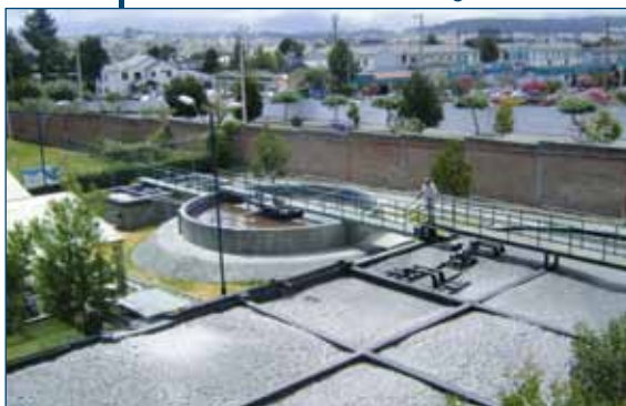
Planta de tratamiento biológico
