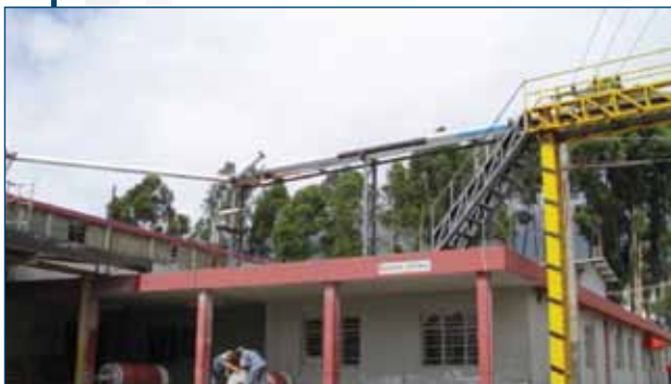
Tubería para distribución de vapor del generador
