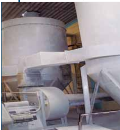
Sistema de ciclofiltros*
