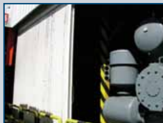
Cerramiento de compresores
