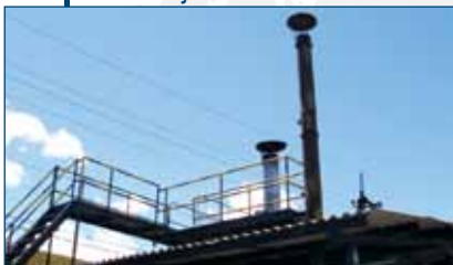
Fuente fija de combustión
