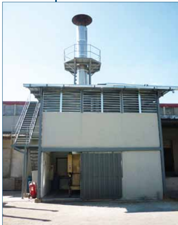
Generador de vapor
