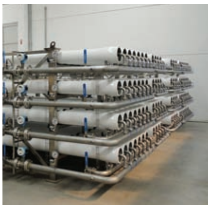
PLANTA DE POTABILIZACIÓN por sistema de osmosis inversa ubicada en Almirante Brown, provincia de Buenos Aires.
