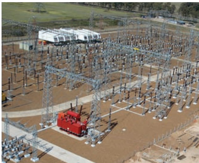
INTERCONEXIÓN ELÉCTRICA Rincón Santa María Rodríguez.
