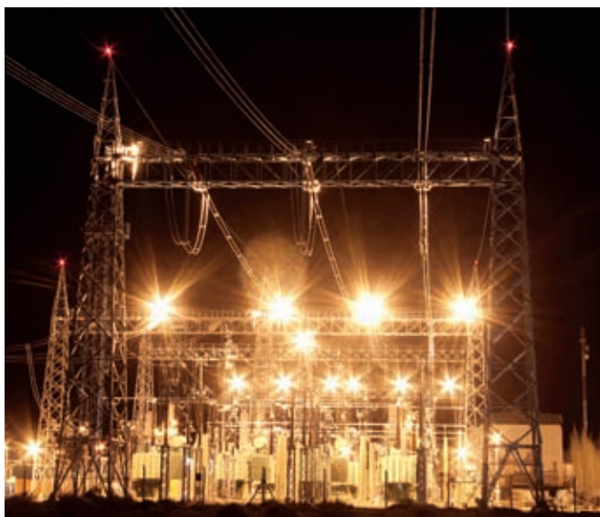
ESTACIÓN TRANSFORMADORA Agua del Cajón, de día y de noche.
