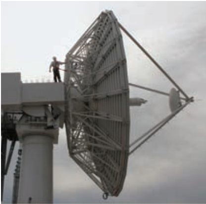
ANTENA de la red nacional de fibra óptica.
