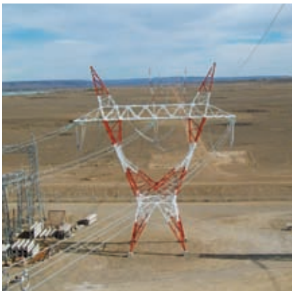
LÍNEA FRÍA , Tramo Norte, salida a la Estación Transformadora Esperanza.
