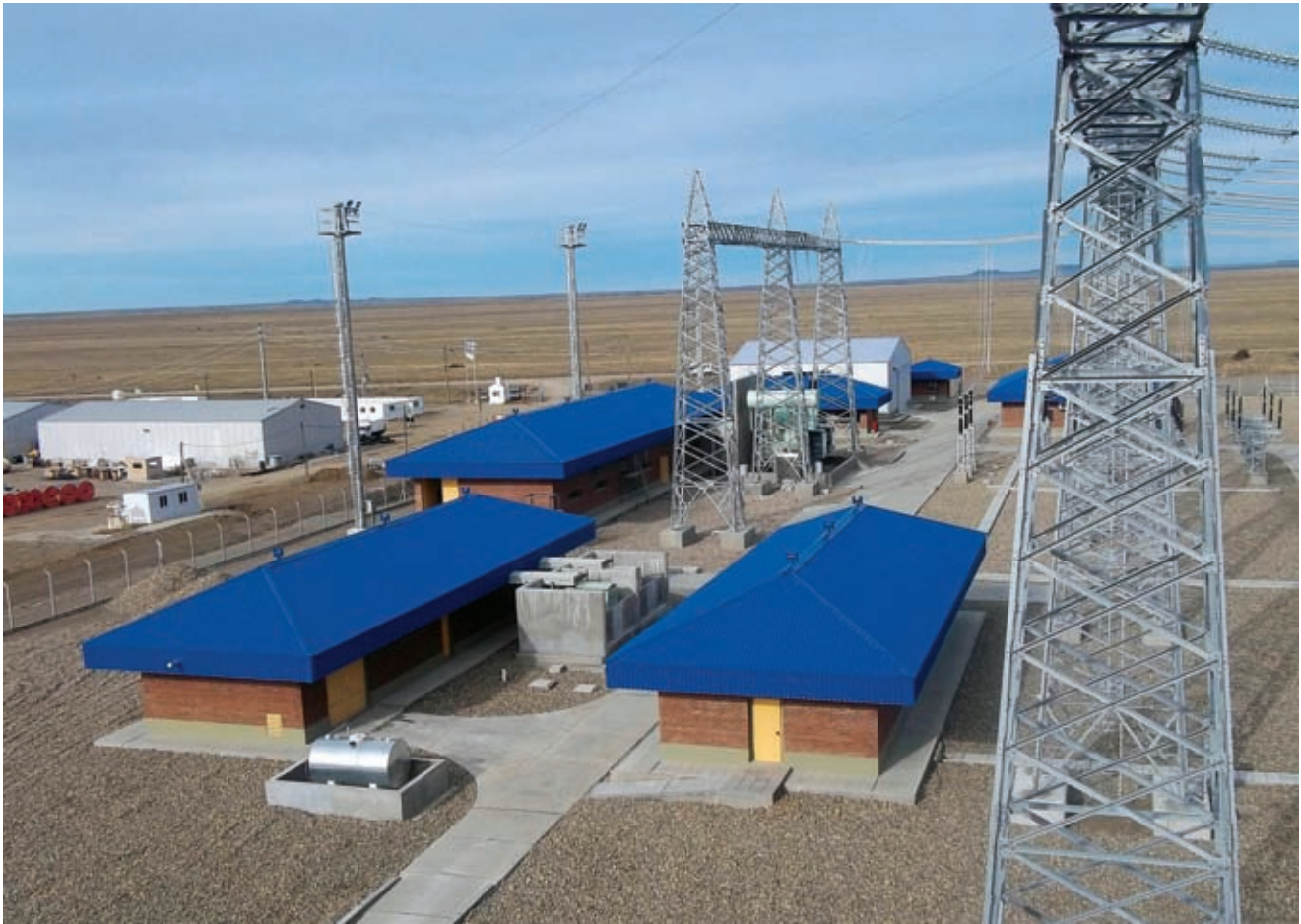
LÍNEA FRÍA, tramo Sur.
