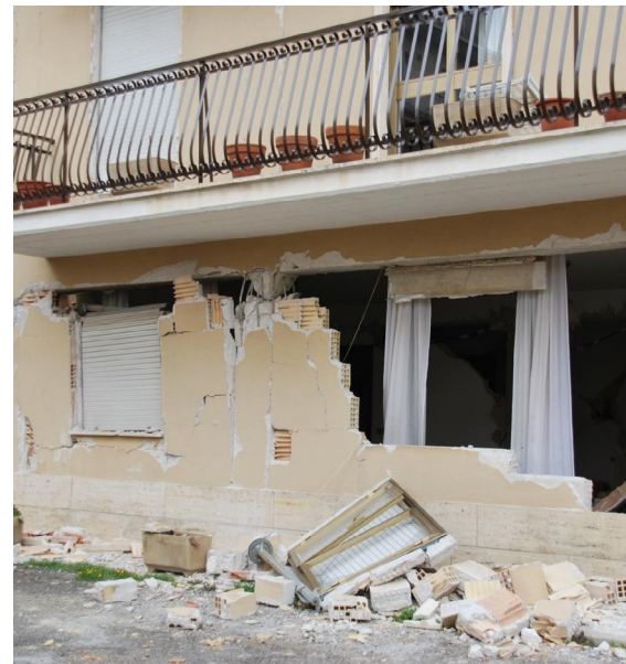
Figura 20. Danos a elementos estruturais e não estruturais devido à sua interação durante terremotos. (Sanchez, J. 2019)
