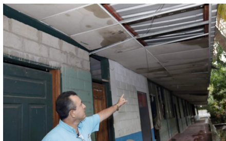
Figura 19. (a) Vista geral de elementos não estruturais 8 ; (b) Danos no forro 9
